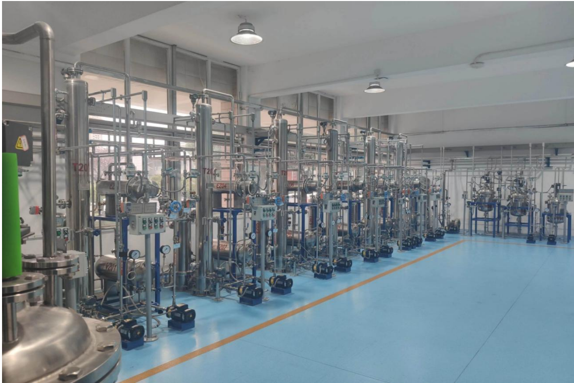
图 4-8 尼龙化工实训室
